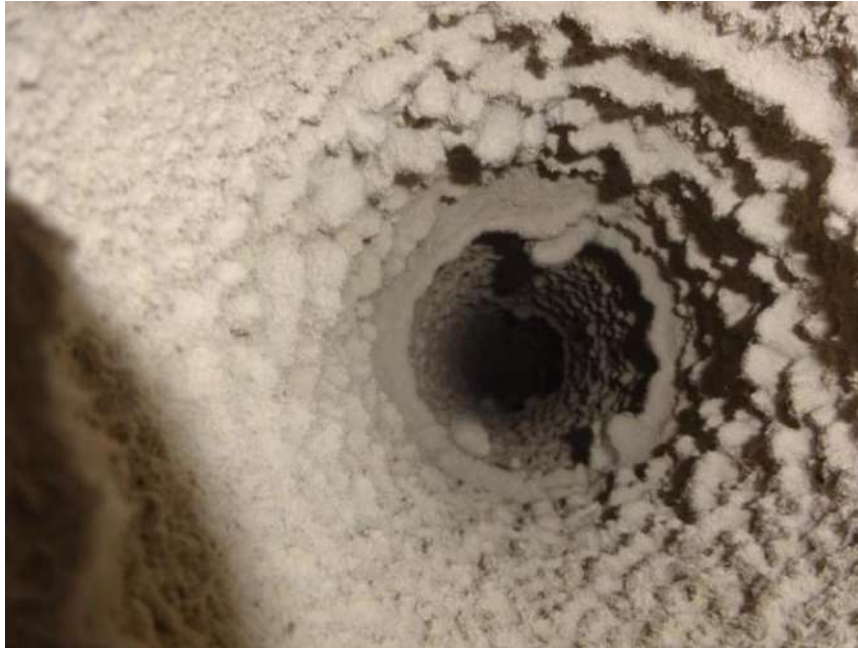
Bilde 5-2: Stikkanal til avtrekksventil i plan 3 – Opphav: Optice AS
