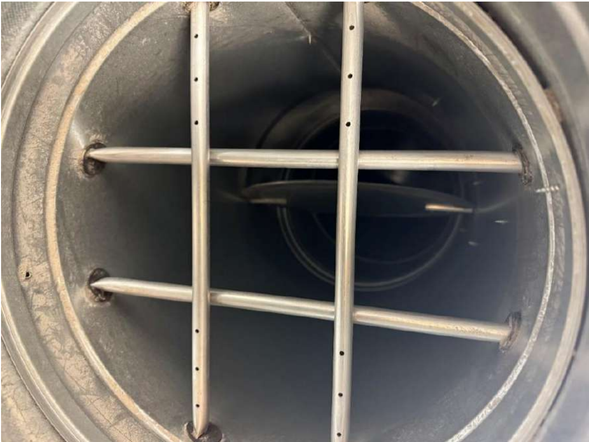
Bilde 2-5: Målekorset innvendig i et VAV-spjeld. Trykket måles via hullene i målekorset – Foto: Stian Brekke
