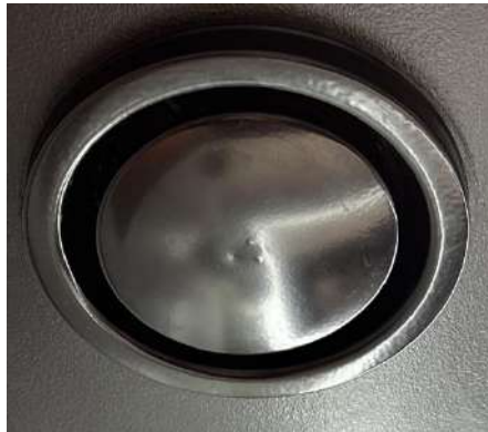
Bilde 3-1: KSO - Avtrekksventil på bad – Foto: Stian Brekke
