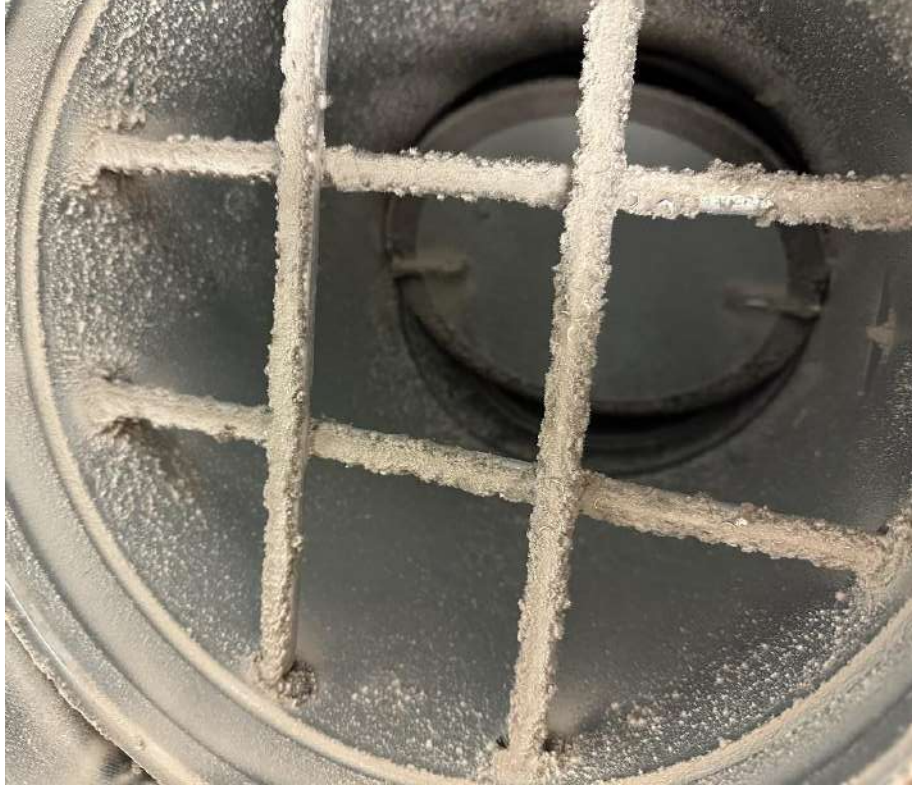
Bilde 5-1: Tilsmusset målekors i VAV-spjeld. Avtrekk plan 3 – Foto: Stian Brekke
